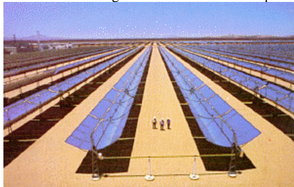
Figuur 9: Concentrerende collectoren in de Mojavo woestijn
