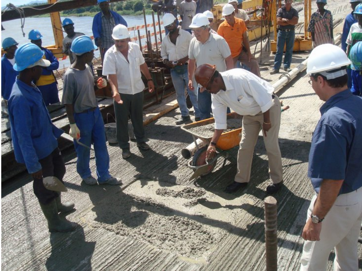
Última betonagem executada pelo Eng. Elias Paulo, então Engenheiro responsável pela empreitada
