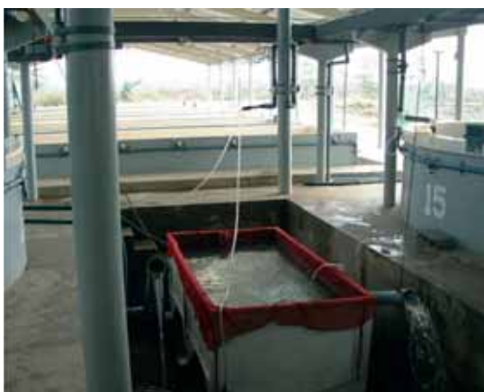
Figura 14. Tanques de acondicionamiento
