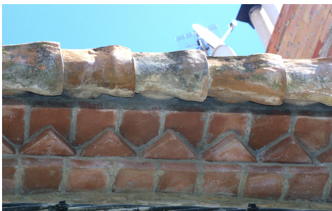
Fig 27 Canalización "tortugada" en tejado.
