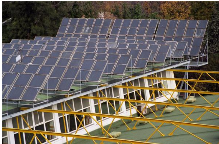
Fig 11A . Placas solares cubierta centro deportivo. Barcelona
