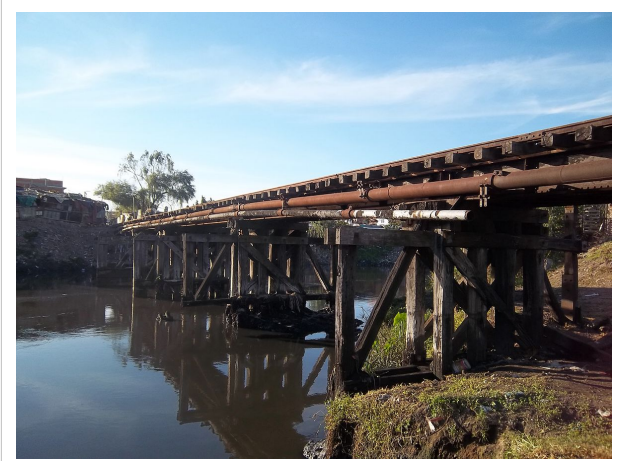
Puente Ingeniero Brian del Ferrocarril General Roca para uso exclusivo de cargas.
