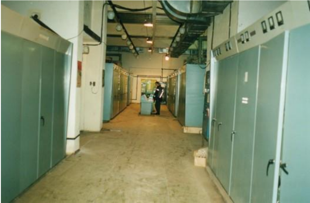
Sala de transmisores del complejo Sura. Y las instalaciones de campo a continuación:
