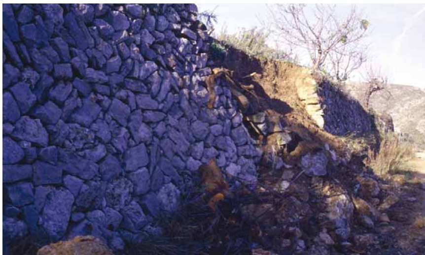
Fig. 9. Fotografía de un relleno de cascajo en un derrumbe
