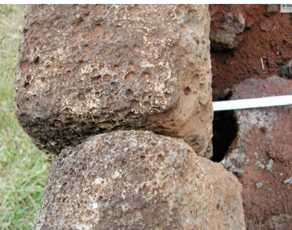
Paenga del muro frontal desprendida del concreto.
