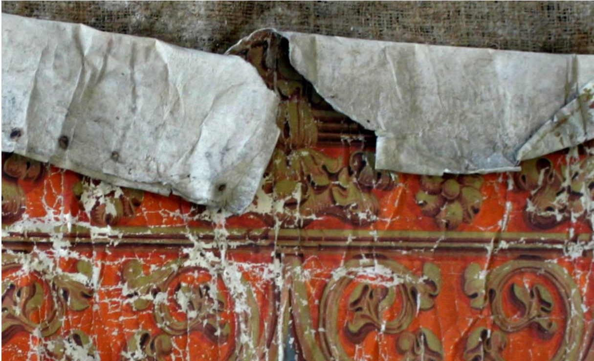
Risse und Knicke in der Bordüre (Detailaufnahme oben Mitte)
